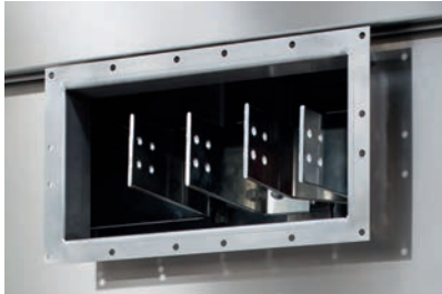
Caja de conexiones en el lado de BT
