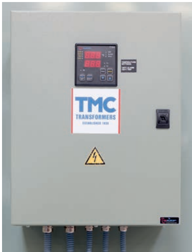
Cuadro de control externo
