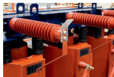
Terminales sobre aislador
